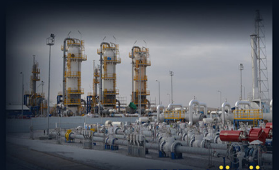
TUZ GÖLÜ DOĞAL GAZ DEPOLAMA TESİSİ
